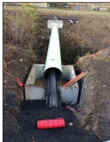
Tube contenant les câbles.
