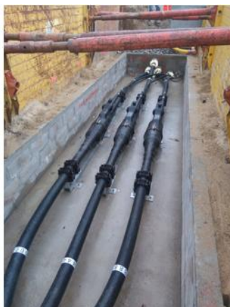
Chambre de jonction
