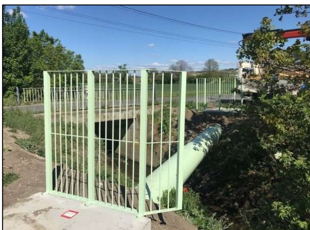
Protection du tube contenant les câbles.
