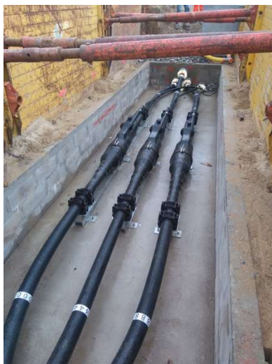
Chambre de jonction
