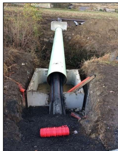
Tube contenant les câbles.
